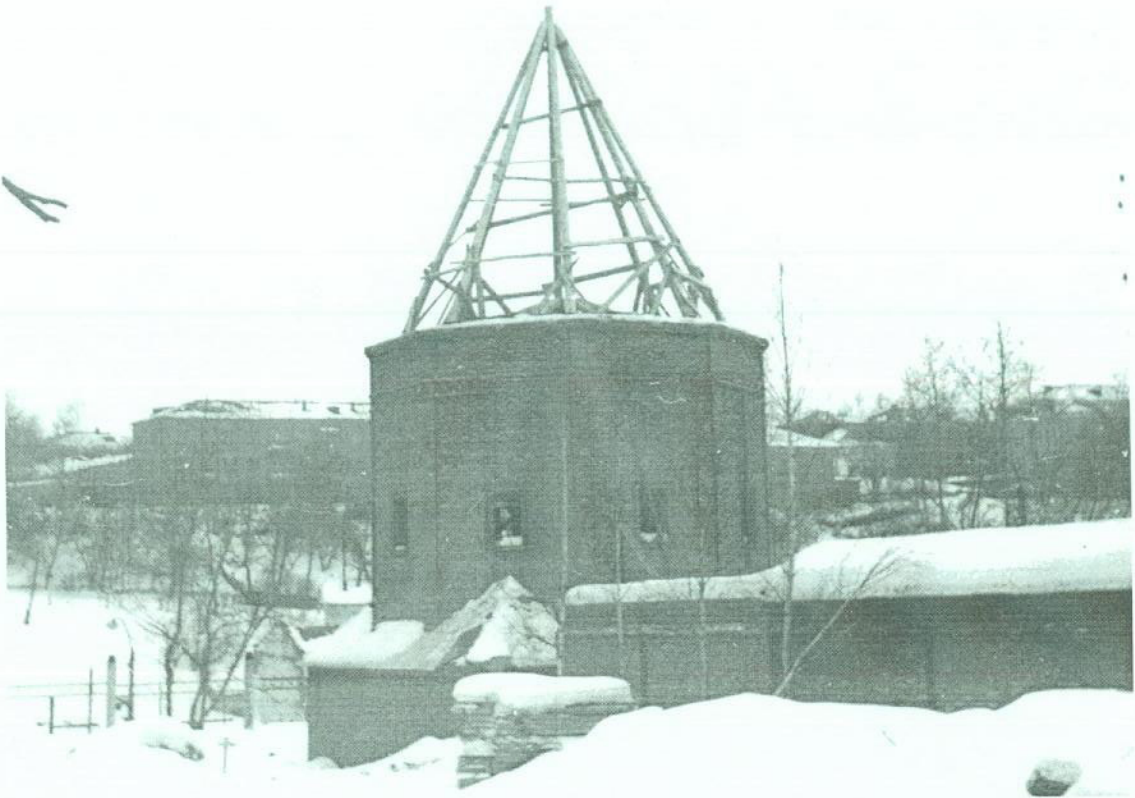
Северо-западная башня ограды Успенского монастыря в г. Кирове. Общий вид строящейся башни с улицы Урицкого, с юго-запада. Февраль 1989 года, Талантов Г.Б., КСНРПМ
