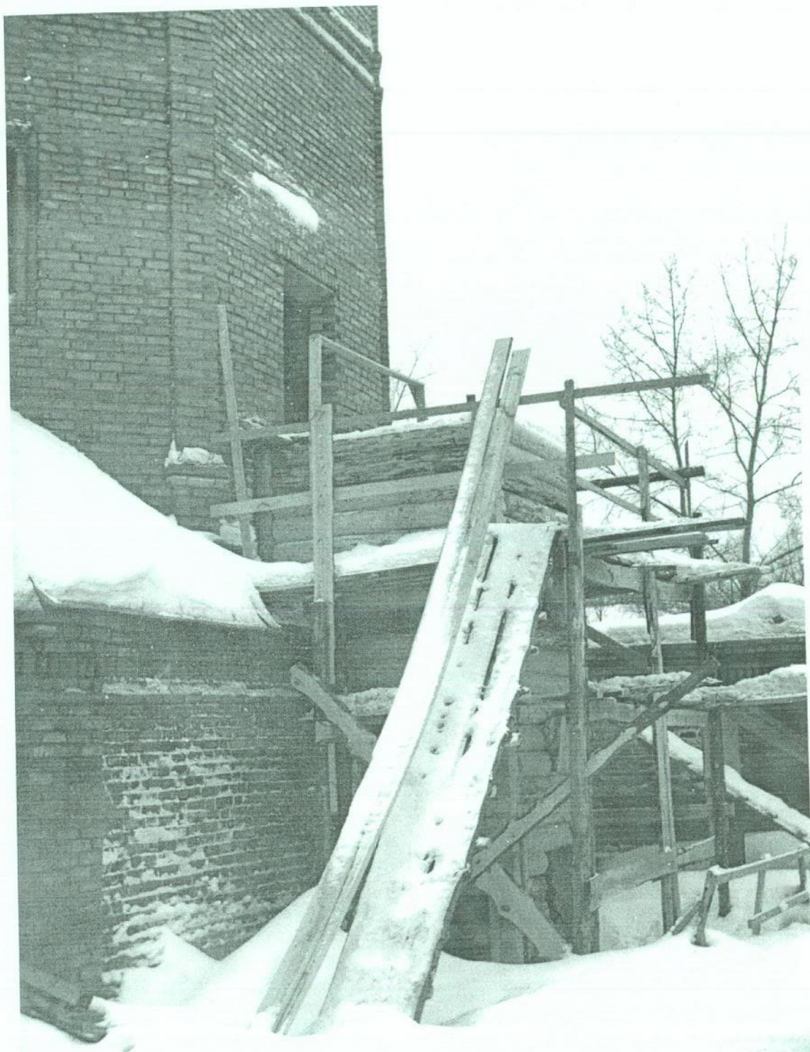
Северо-западная башня ограды Успенского монастыря в г. Кирове. Фрагмент строящейся башни. Восточная грань. Сруб рундука. Февраль 1989 года, Талантов Г.Б., КСНРПМ
